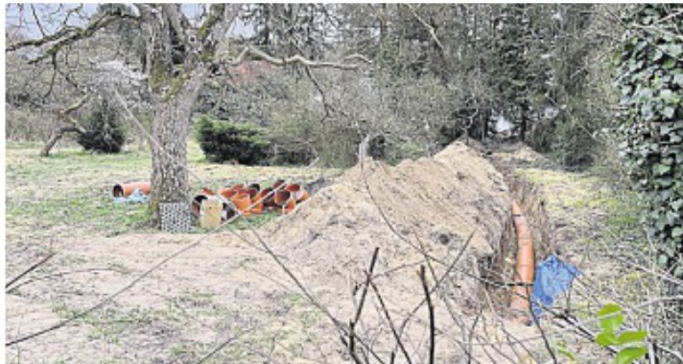
Die Rohrleitung zum Salemer See.
